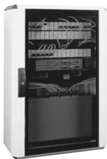
Coffret (ou armoire) de brassage.
